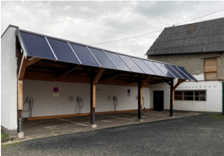
Abbildung 53 PV-Anlage auf einem Vordach.
