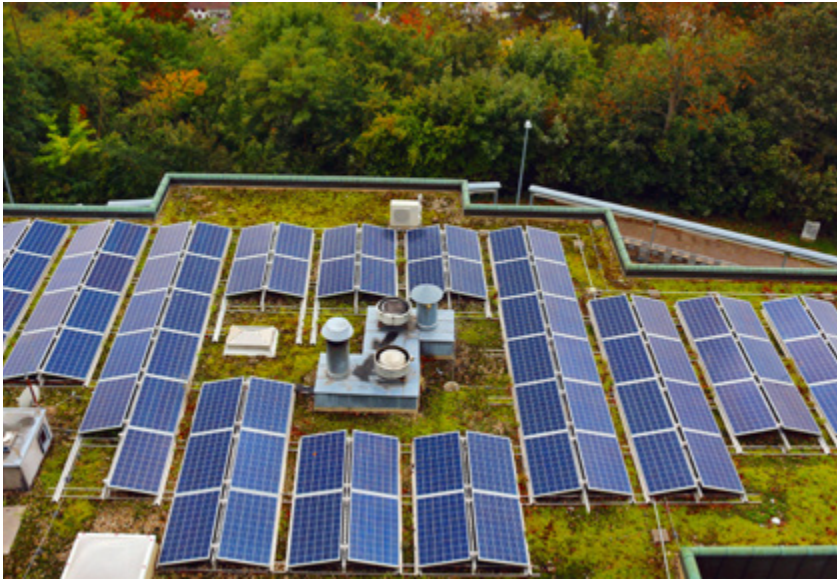
Abbildung 28 PV-Anlage auf einem Gründach.
