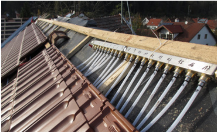
Abbildung 27 In Dachziegel integrierte Solarthermieranlage.
