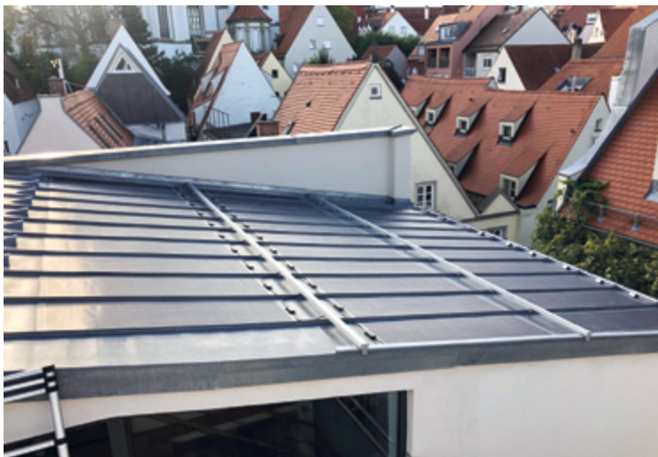
Abbildung 57 Leichte, aufgeklebte Module auf einem Metaldach.
