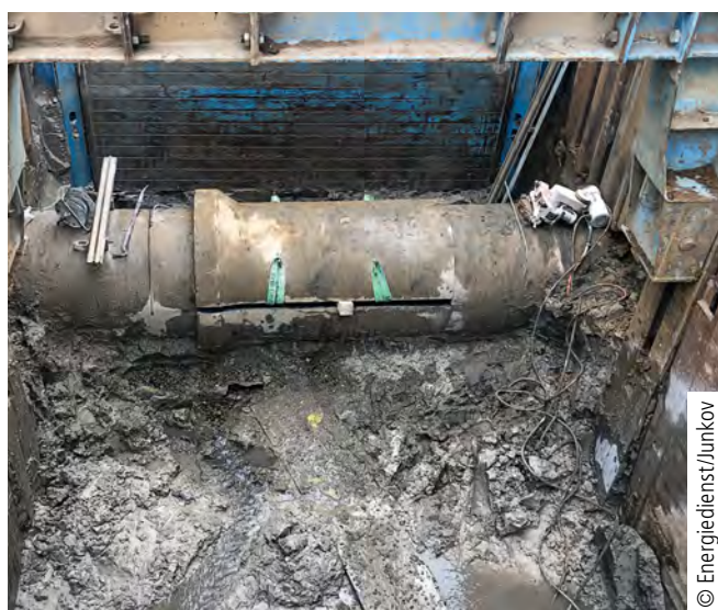
Abb. 3: Sammler des Abwasserzweckverbands Breisgauer Bucht mit 90 cm Durchmesser und 23 Liter pro Sekunde Trockenwetterabfluss. Ein Teilstrom des Abwassers wird in ein Entnahmebauwerk abgezweigt und durch einen Siebrechen grob gereinigt.
