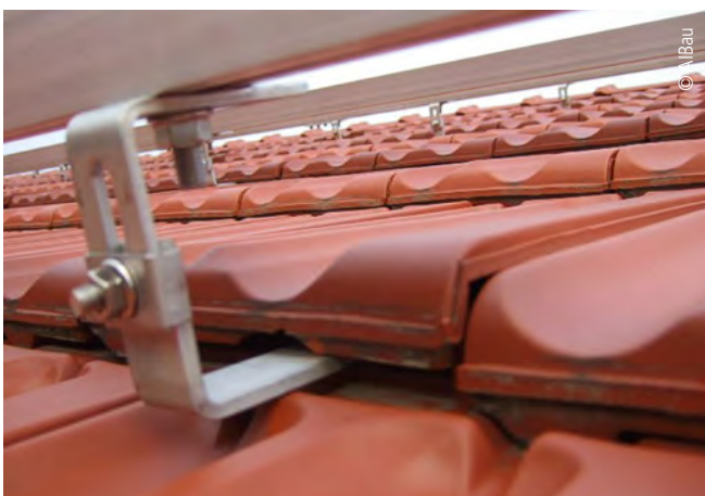
Abb. 5: Bearbeitung an der falschen Stelle, dadurch angehobener Ziegel und zu große Einschränkung der Regensicherheit
