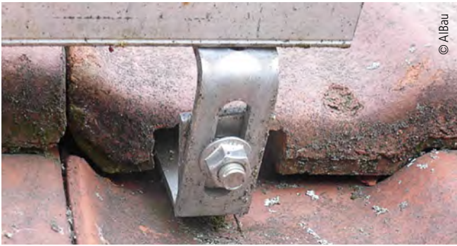
Abb. 3: Nicht mehr als nötig ausgefräste Fußrippe
