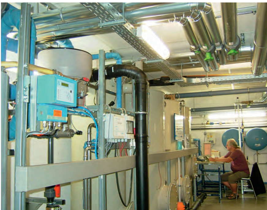
Abb. 4: Mehrstufige Aufbereitungsanlage für Grauwasser im Berliner Mietshaus am Arnimplatz. Die biologische Reinigung erfolgt im Wirbelbettverfahren mit anschließender UV-Desinfektion. (Foto: König)
